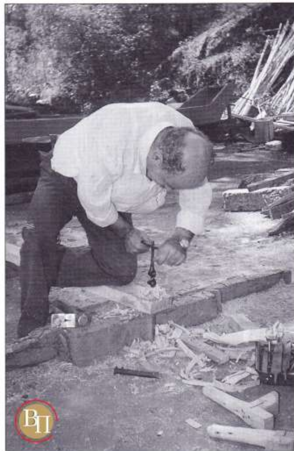
Η αρίδα «επί το έργον» προετοιμάζει το τροχαντήρι να υποδεχτεί το σκαρμό. The drill is preparing the outrigger beam to receive the oar lock.
